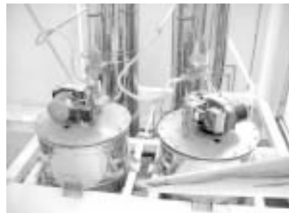
Foto. N° 8 Detalle de quemadores
